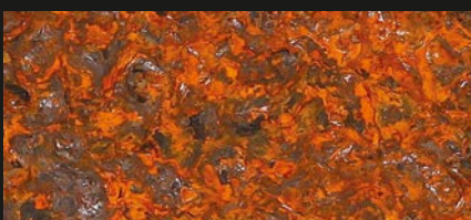
Sans traitement de protection anticorrosion
